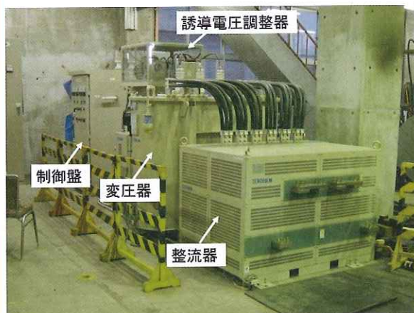
直流低圧大電流試験装置
