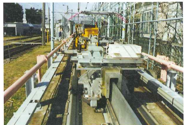
集電試験装置
