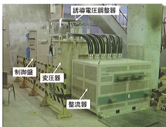
直流低圧大電流試験装置
