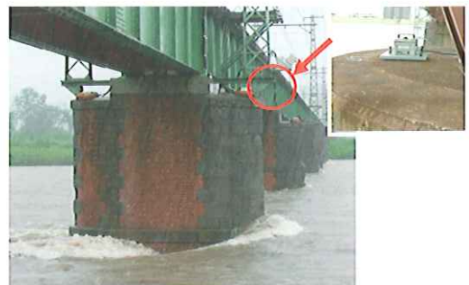
河川増水による橋脚の不安定化モニタリング
