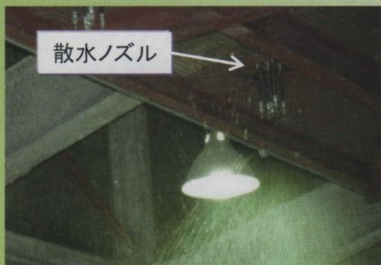
ノズルからの散水状況
